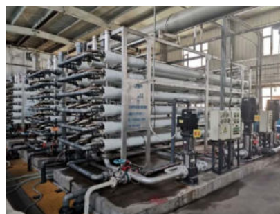
图 吉林化纤压洗废水处理设备
